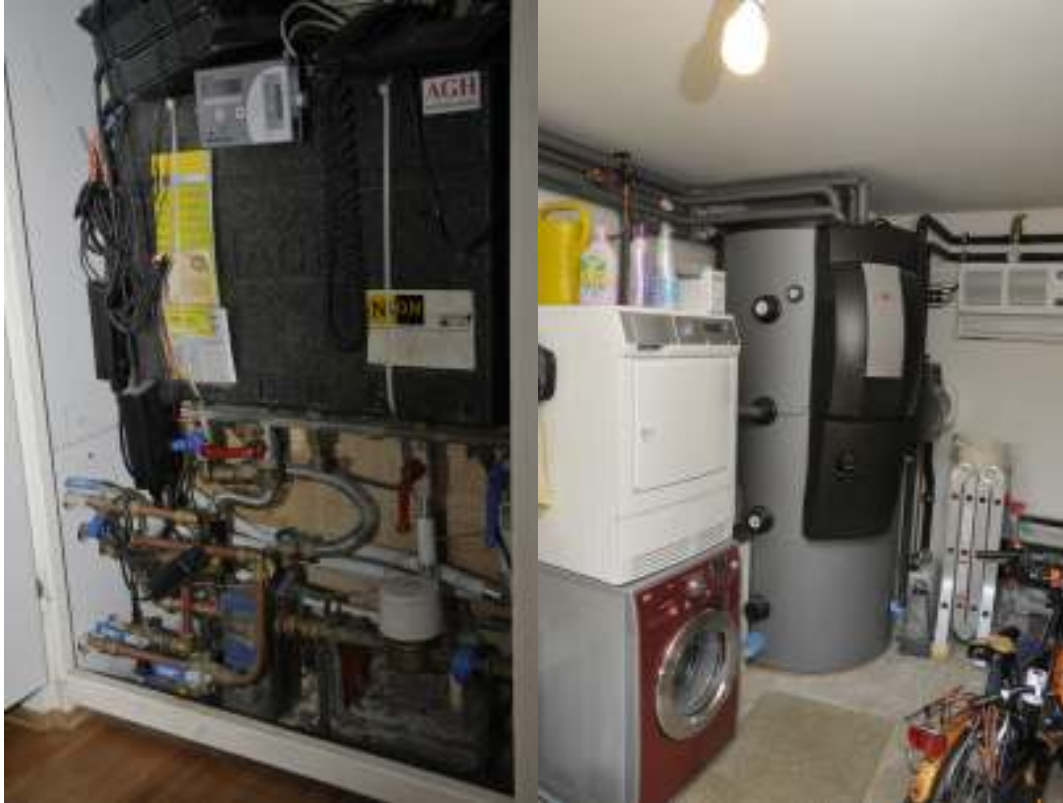
In de meterkast: meer leidingen
